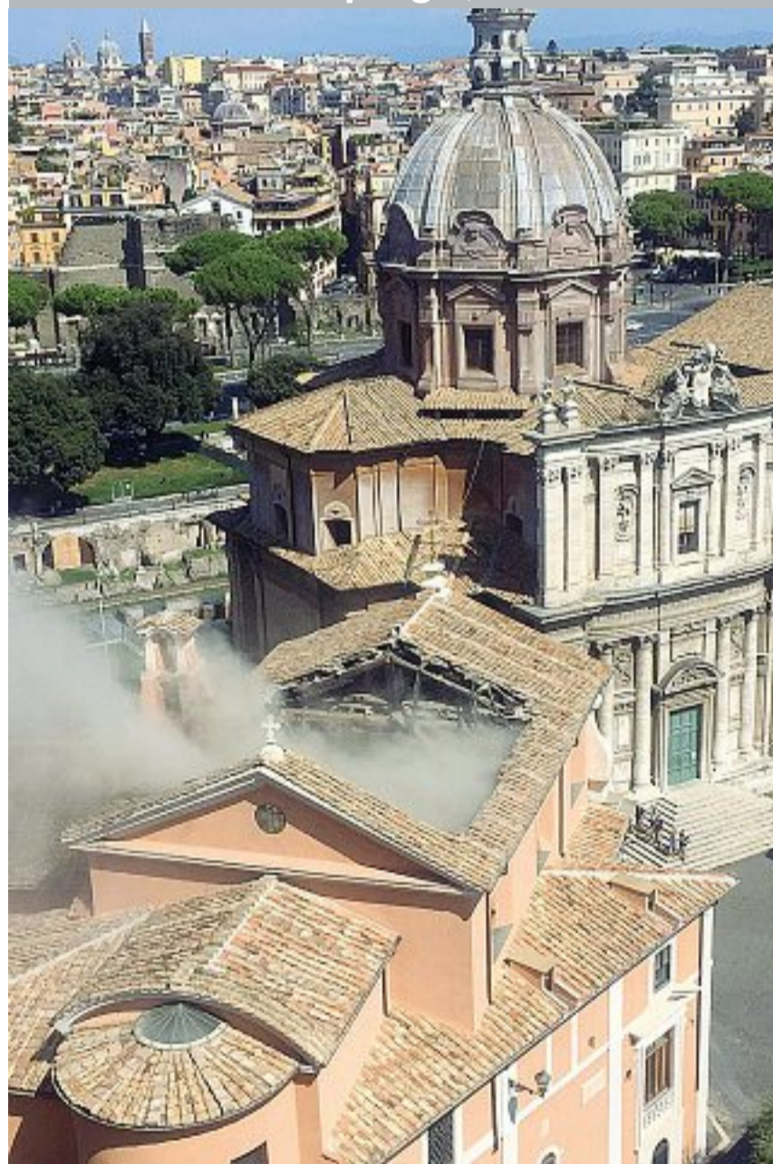
Il tetto crolla, la polvere sale al cielo. La chiesa di San Giuseppe dei Falegnami poco dopo il cedimento
