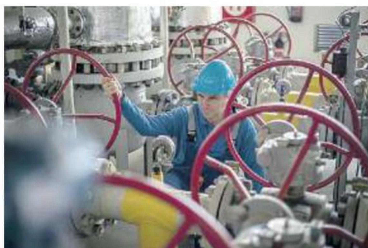
RUBINETTI Un impianto di distribuzione del gas in Repubblica Ceca
